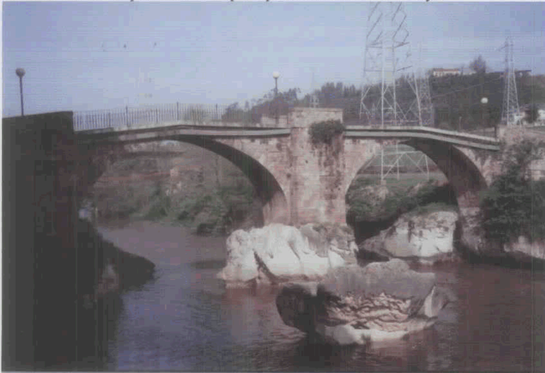
Antiguo Puente del Ganzo, hoy muy degradado por las obras de la autovía y los tendidos eléctricos
